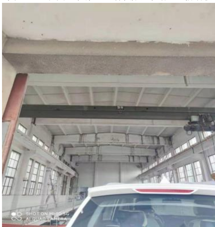
图 2.3-9 水源地一级泵房桥机
